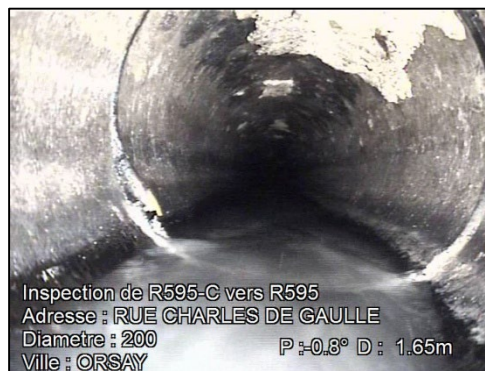
Joint d'étanchéité rompu
