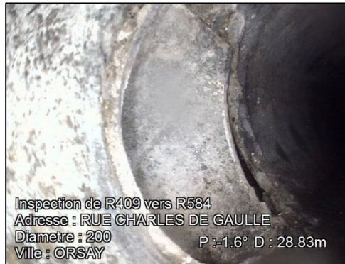
Raccordement non étanche
