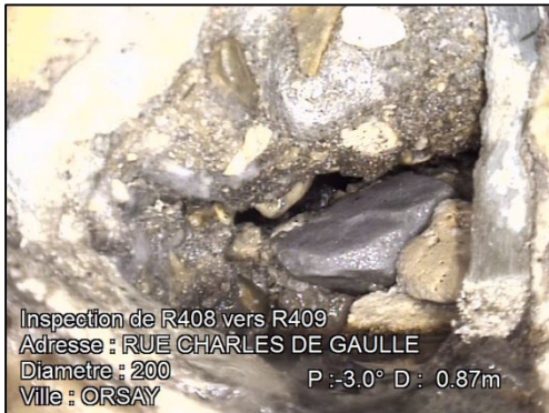
Perforation de la canalisation
