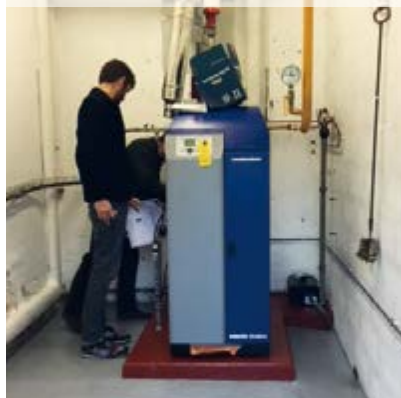
Chaufferie de la maison des associations Après
