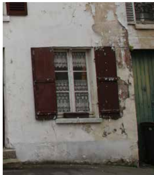
Détail du délabrement de la façade
